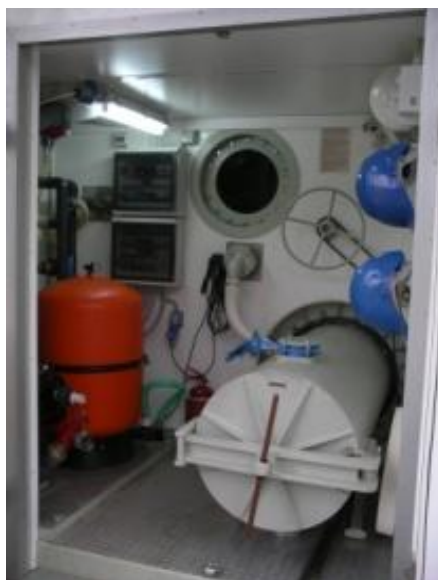
Вид на систему водоподготовки
