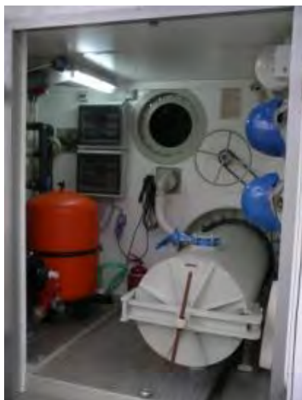
Вид на систему водоподготовки
