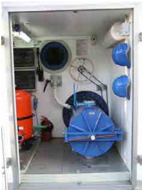
Вид на систему водоподготовки
